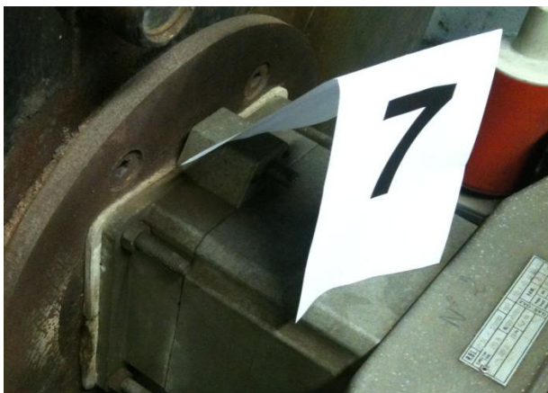
Figura 34 - guarnizione locale caldaia
